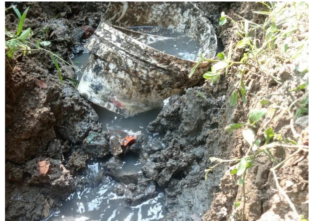
Gambar 2. Kondisi bak kontrol pecah
