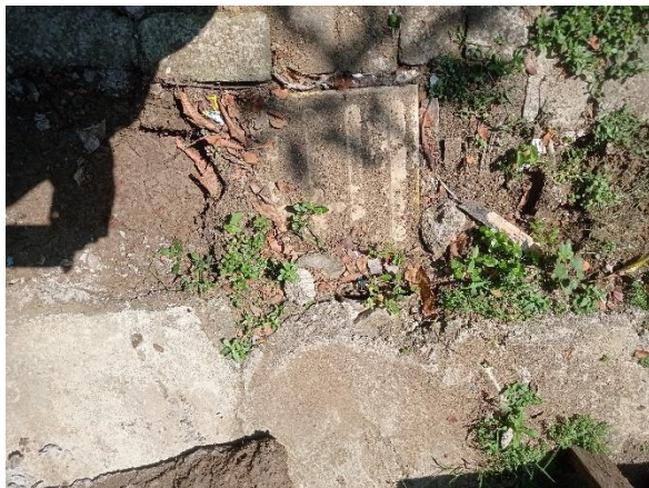
Gambar 3. Kondisi penutup bak kontrol
